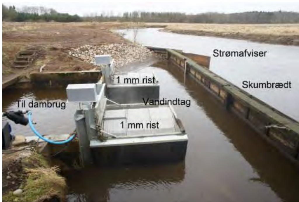
Figur 17 Indløbsbygværk ved Sig Fiskeri i Varde Å (foto: Jan Nielsen, DTU Aqua /11/).
